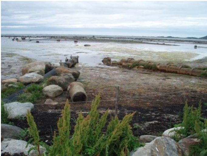
Bilde 8: Dreneringsrør ut i verneområdet Foto: Britt Agnes Buvarp
